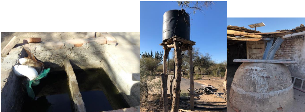
Figura 51: Sistema de filtrado - Figura 52: Cisterna, motobomba y tanque elevado - Figura 53: Aljibe (07/07/19) (17/07/21) (17/07/21)
