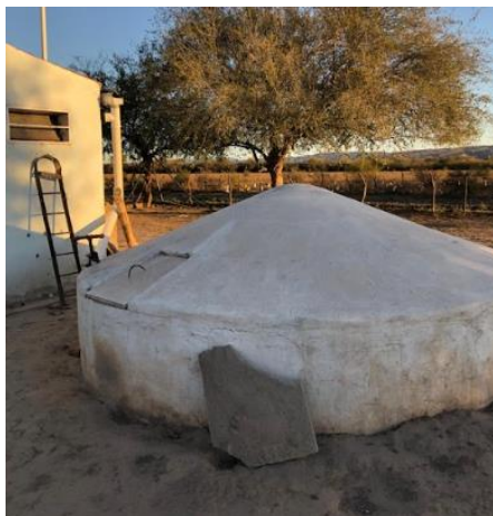
Figura 43: Cisterna de 16.000 litros (17/07/21)
