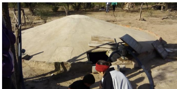
Figura 50: Cisterna comunitaria 52.000 litros (07/07/19)
