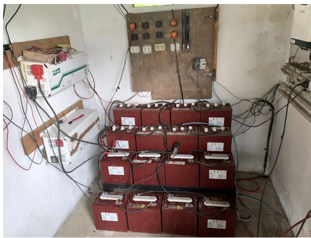
Figura 9: Sistema de baterías del complejo habitacional.
